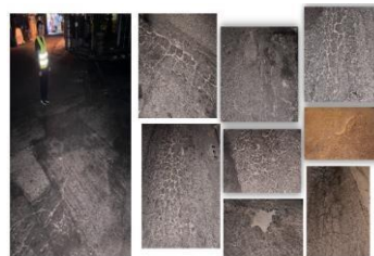
Gambar 3. Tipe Kerusakan Perkerasan Jalan
